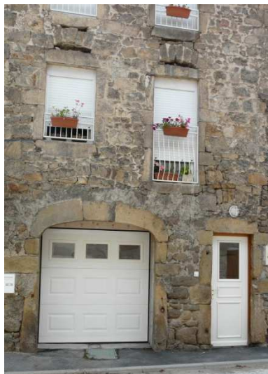
Exemple de façade où la forme et l'aspect des menuiseries ne respectent par l'architecture de l'édifice...
