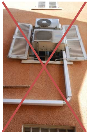
appareillage de climatisation rapporté
